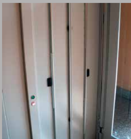
porte di cabina a soffietto
